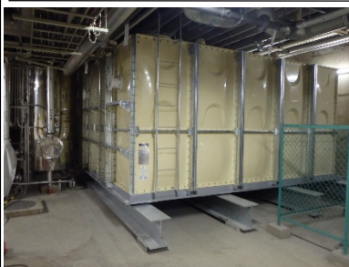
↑エネルギーセンター内に新設された耐震性の上水貯水槽
