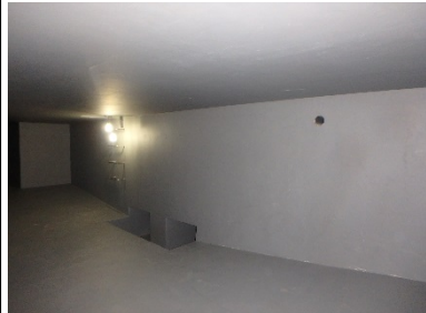
↑防災庁舎内地下ピット汚水タンク 災害で下水管が損傷した時に非常用の汚水タンクとして使われる
