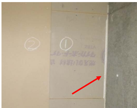
↑防火区画壁の施工状況。石膏ボードを2重に張り、コンクリート壁には耐火に優れたロックール(矢印)を詰めている。国土交通大臣認定されたメーカー指定の工法に準じて施工している。
