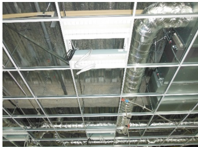
↑下地の組立状況。白いパネルが、規格の天井照明で、同様に空調送風口も取付られる。
