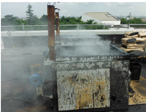
↑溶融釜にて熱してアスファルトの塊を溶かしている状況
