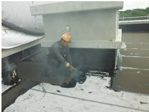
↑アスファルトルーフィングシートを溶かしたアスファルトで張付けている施工状況
